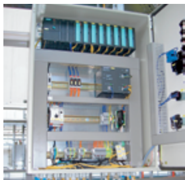
Der Schaltschrank mit acht AS-Interface-Mastern enthält die gesamte Steuerungselektronik – und lässt locker Platz für ein Bedientableau.
